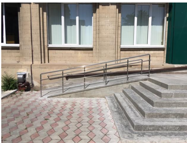
RAMPA LA BLOCUL DE STUDII NR 4, UNIVERSITATEA DE STAT DIN MOLDOVA CU GRADUL DE ÎNCLINAȚIE 17% FAȚA DE 8% CONFORM NORMATIVELOR TEHNICE NAȚIONALE
